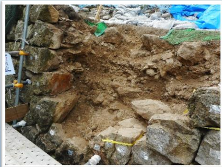
令和2年から行われている黒門跡石垣修復工事のようす
